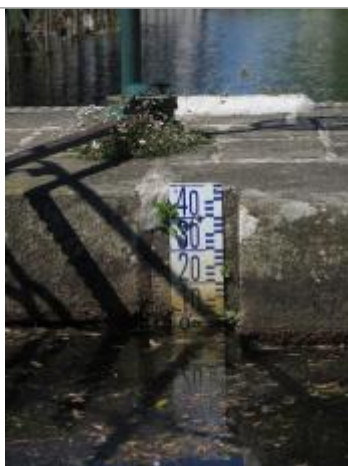
Echelle amont de l'écluse de Lestitut
