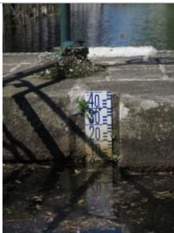
Echelle amont de l'écluse de Lestitut
