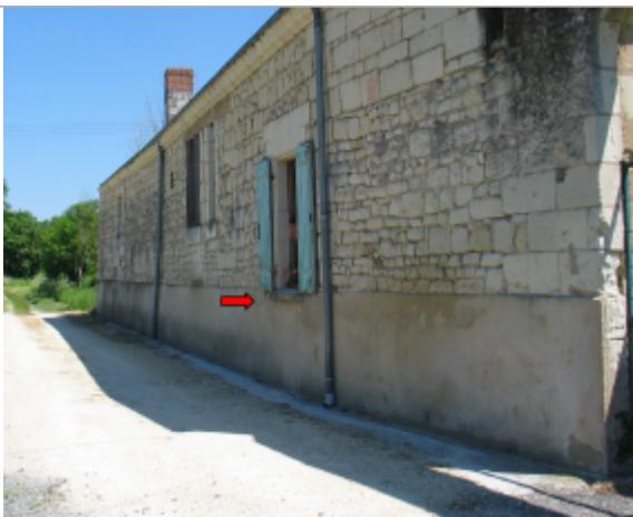
Eau au ras de l'appui de fenetre
