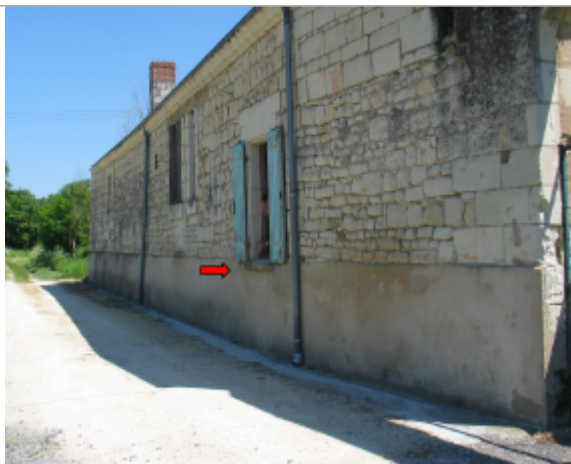
Eau au ras de l'appui de fenetre
