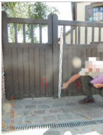
Laisses d'inondation sur le portail (photo SPC SACN)
