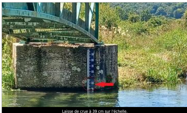
Laisse de crue à 39 cm sur l'échelle.
