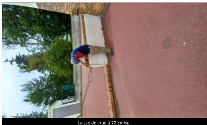
Laisse de crue à 72 cm/sol.
