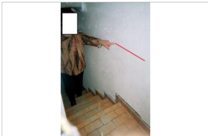
Niveau de l'inondation dans le sous-sol de la maison
