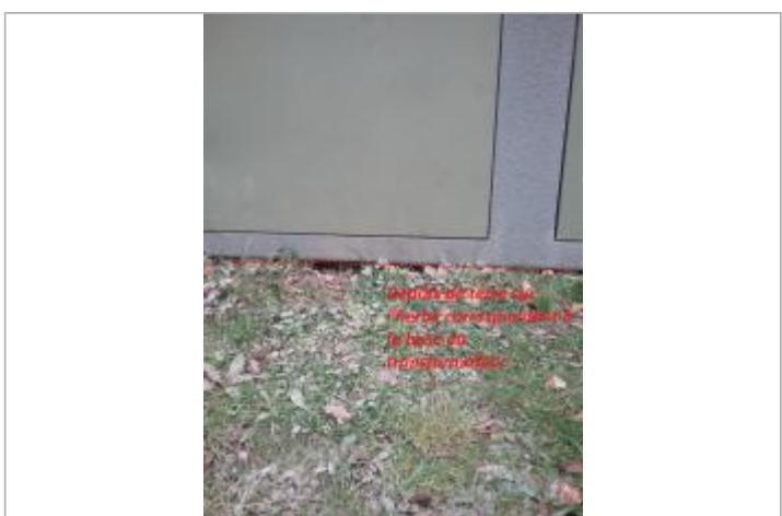
pente au droit du poste de tranformation (dépôt de sédiments sur l'herbe)
